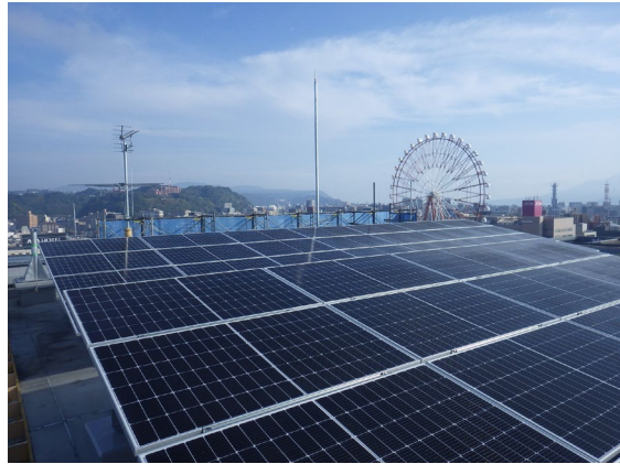
【太陽光設置写真 一部】
